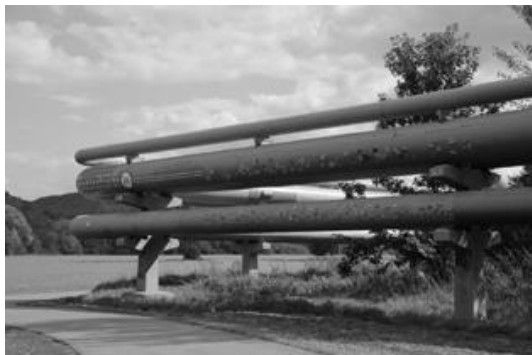
Fig. 4.18 Conduites de chauffage à distance de surface à Iéna (Stadtwerke Energie Jena-Pössa).
